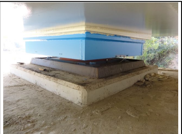
교량받침 P2-SH2 거푸집 미제거
